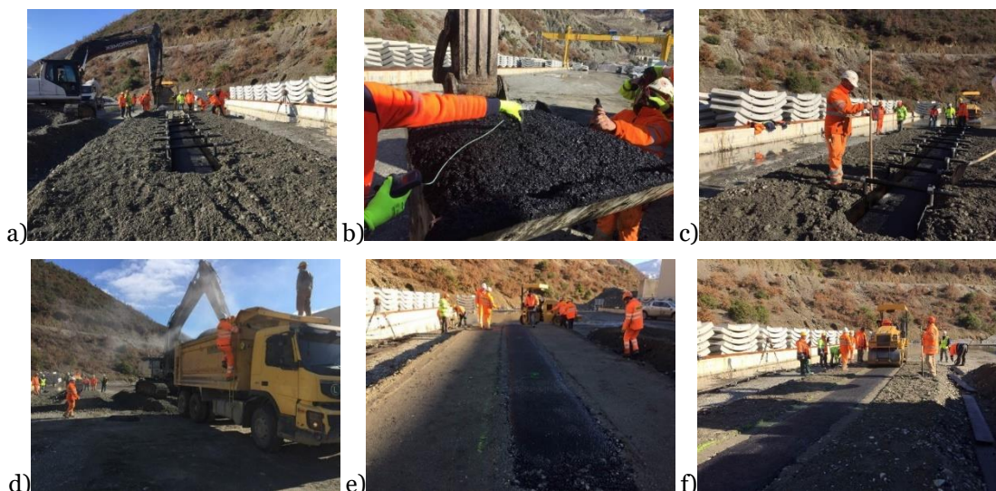
Figura 4.9 - Construção do trecho experimental à mão: a) Colocação do filtro ao redor da cofragem; b) Controlo de temperatura da mistura antes de aplicada; c) Verificação das espessuras d) Colocação da mistura dentro da cofragem; e) Remoção da cofragem; f) Compactação do núcleo asfáltico
