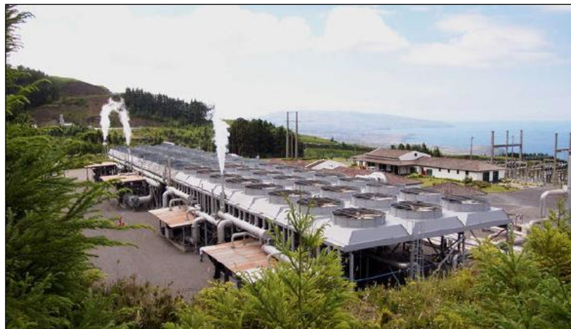
Figura 2.2 - Central Geotérmica da Ribeira Grande (Rio, 2011).
