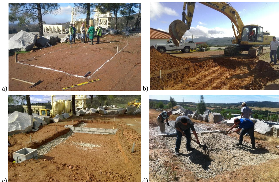
Figura 5.9 Fases da construção do TE1: a) Marcação do terreno; b) Escavação do terreno; c) Construção da parede divisória, caixas de recolha e colocação dos tubos de drenagem; d) Colocação do tout-venant e das britas
