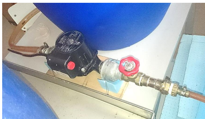
Figura 3.26 - Mode de implementação da bomba exterior de circulação.
