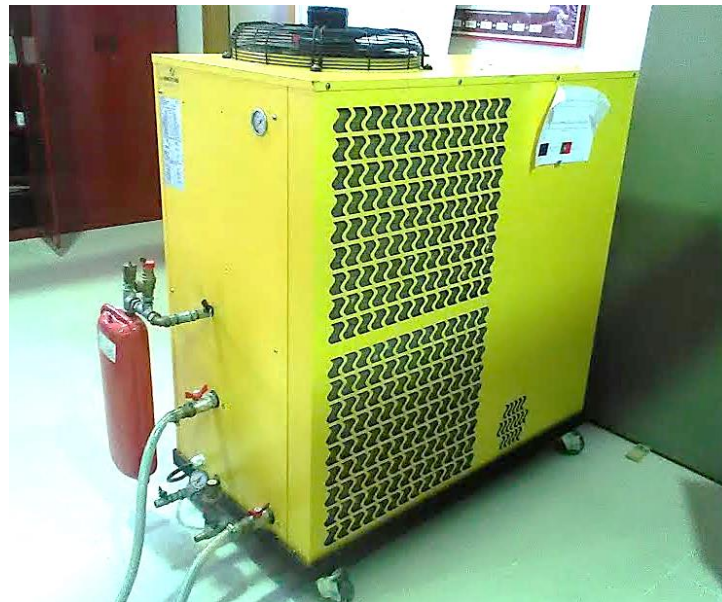
Figura 3.24 - Chiller de refrigeração utilizado.
