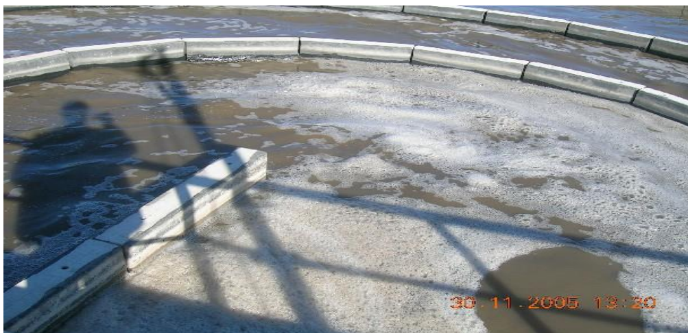
Figura 2.10: Tanque de arejamento de sistema de baixa carga por arejamento prolongado
