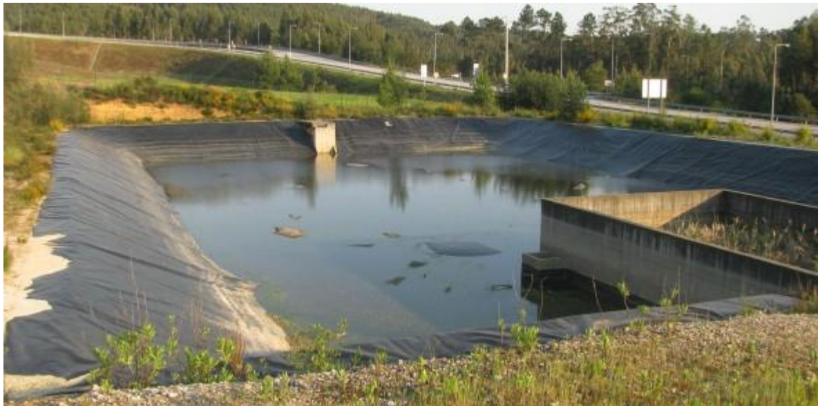
Figura 3.4 - Bacia de retenção para AEE
