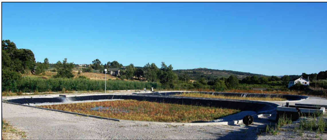
Figura 4.9 - ETAR de macrófitas na Freguesia de Prova, do Concelho de Mêda na Freguesia da Prova.
