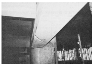
Fig. 1.3 - Rotura frágil por torção de uma viga num edifício [13]
