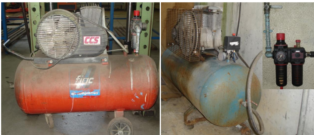
Figura 2.15 - Compressores móvel e fixo de ar comprimido
