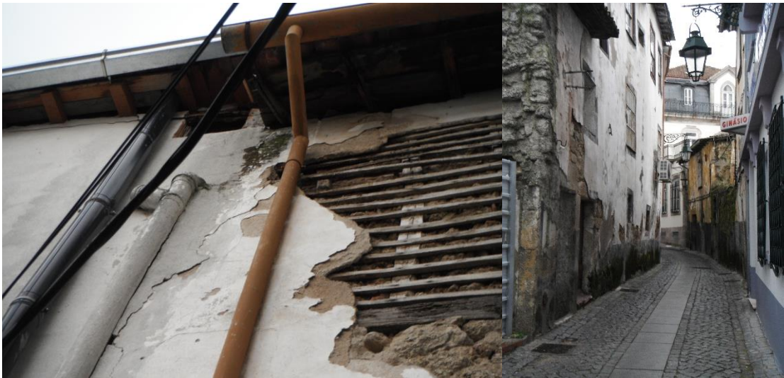
Figura 24: Degradação das fachadas da Rua do Ginásio
