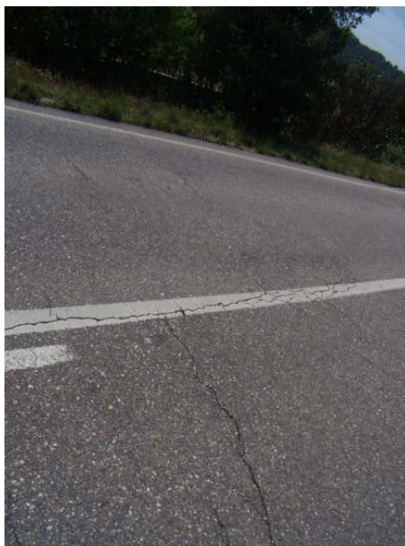
Figura 3. 1: Fenda transversal na faixa de rodagem e longitudinal ao eixo da via no pavimento existente antes da obra de reabilitação.
