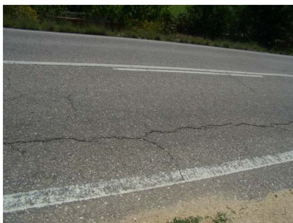
Figura 3. 2: Fenda longitudinal no pavimento existente antes da obra de reabilitação.
