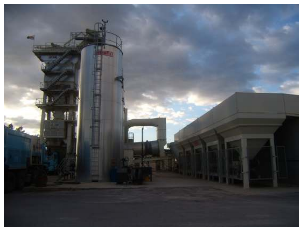
Figura 3. 6: Central descontínua a quente utilizada para efectuar a mistura betuminosa reciclada.
