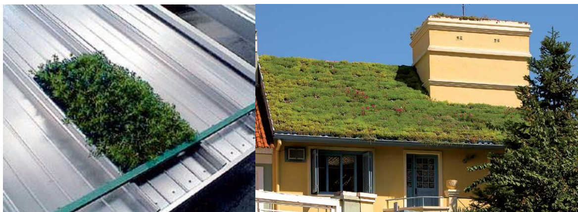
Figura 4.17 Exemplo da aplicação do sistema eco-telhado , em Porto Alegre.
