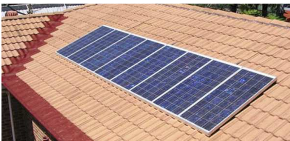
Figura 53. Imagem dos painéis fotovoltaicos
