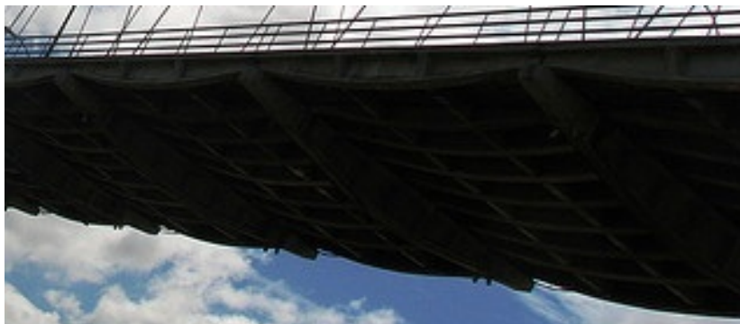
Figura 4.7 - Imagem do tabuleiro, vista inferior da ponte sobre o rio Zambeze, http://www.panoramio.com . 22-05-11 10:10.
