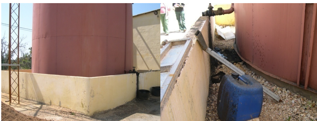
Figura 6.7 – Depósito de armazenamento de fuelóleo e respectiva bacia de retenção (imagem cedida pela ARH do Algarve)
