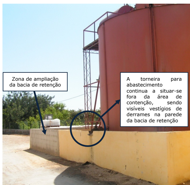
Figura 6.20 – Sistema de armazenamento de fuelóleo para abastecimento de sistema de geração de vapor (imagem cedida pela ARH do Algarve)
