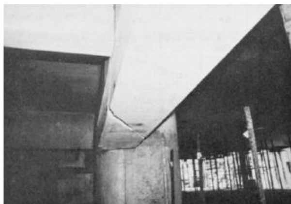
Figura 1.1 - Rotura frágil por torção de uma viga de um edifício [21].
