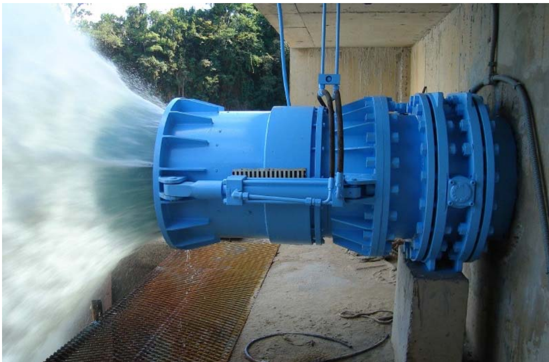
Figura 72 - Válvula dispersora em funcionamento.
