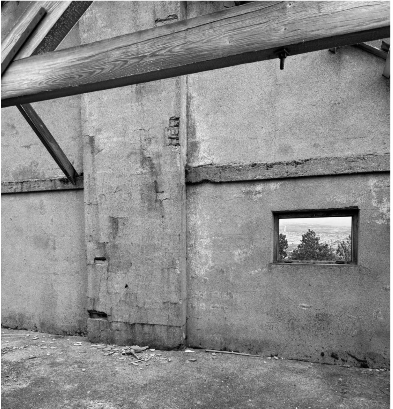
Figura 34 - O estado de degradação do betão sujeito às condições climáticas
