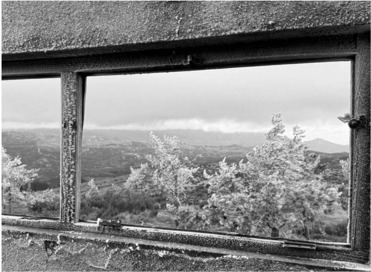
figura 35 - Estado de degradação das caixilharias
