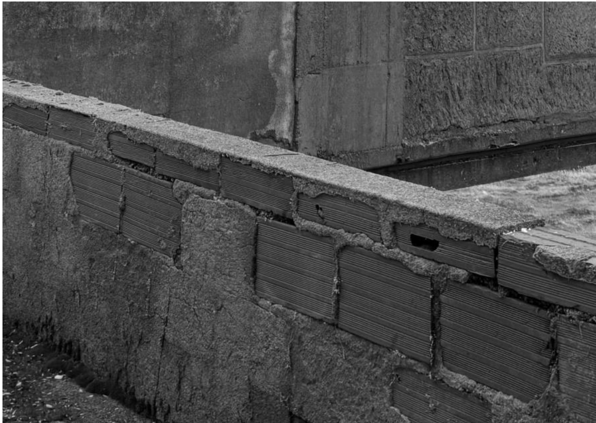
figura 36 - Estado de degradação de rebocos, tijolos e betão
