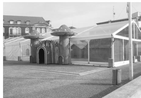
Figura 24 - Mercado 2 de Maio, Montagem estrutura metálica, feira de Natal. (fotografia cedida em: fotografia: ruadireita.pt em: 2017-09-10).
