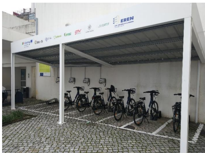
Figura 3.2 Posto de carregamento da Residência Universitária do Sineiro.
