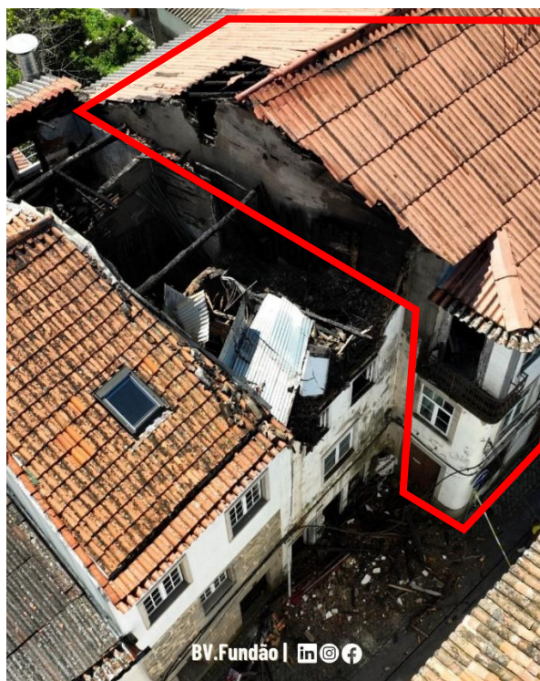
Figura 4. 73 - Edifício adjacente após incêndio ( Bombeiros Voluntários do Fundão, Redes sociais, 2024)
