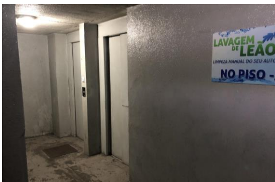
Figura 3.50. Elevadores presentes no silo (Fonte: Autor).
