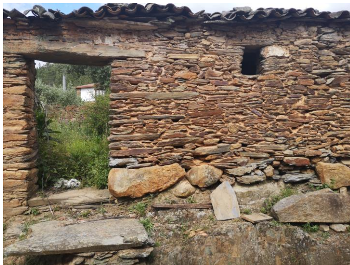
Fig. 26 Edifício em ruína 89
