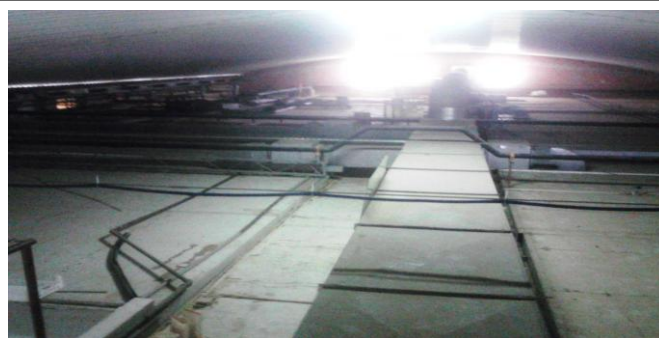
Figura 13 - Vista Geral da Tubulação das Câmaras 4, 5, 6 e 7
