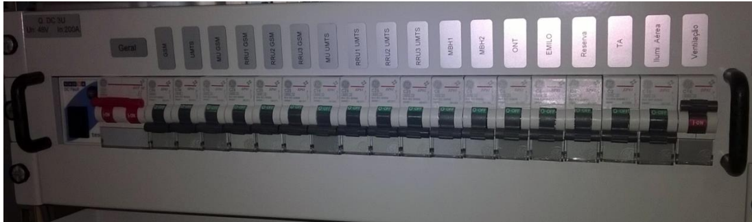
Figura 6 - Quadro de corrente DC.
