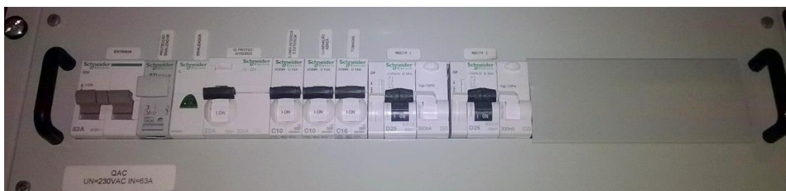
Figura 5 - Quadro de corrente AC.
