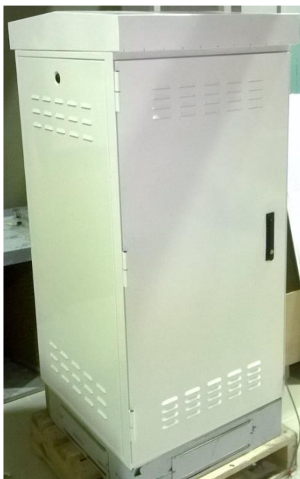
Figura 2 - Armário exterior de telecomunicações.
