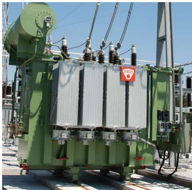
Figura 11 - Transformador de Potência.
