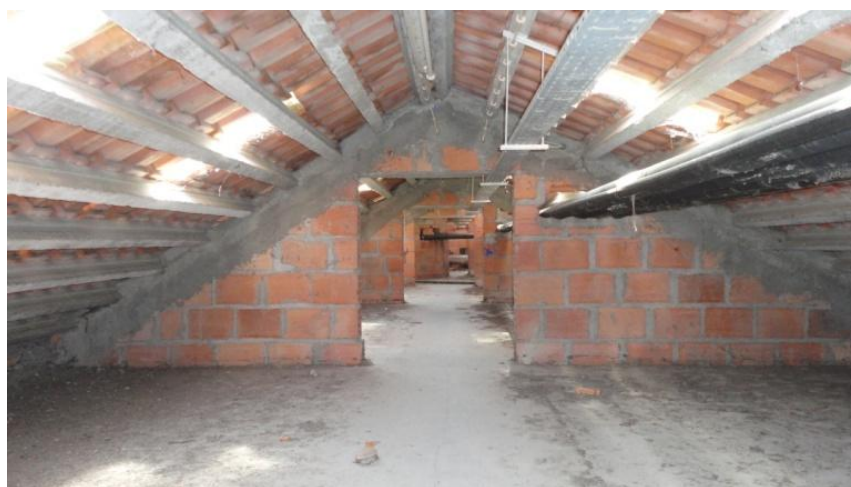
Figura 63 - Deficiente isolamento do telhado. Fonte: Fotografia nossa.
