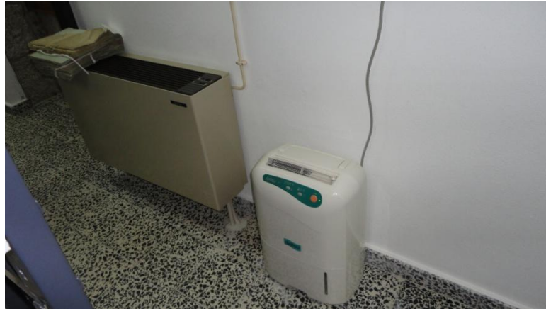
Figura 64 - Desumidificadores. Fonte: Fotografia nossa.
