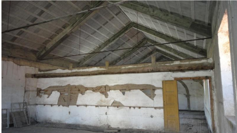
Figura 31 - Instalações degradadas por uma invasão de pombas. Fonte: Fotografia nossa.
