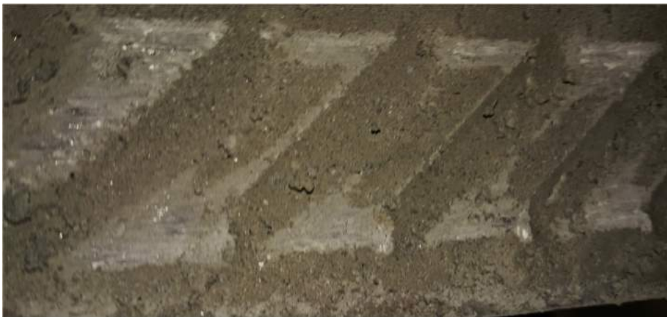
Figura 98 - Esmagamento do betão na interface (betão) - CP.2.H60
