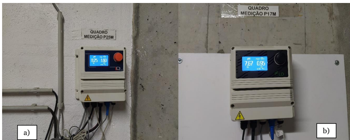
Figura 3.7 - Consolas de controlo de pH e Cloro: a) tanque de 25 m; b) tanque de 17 m
