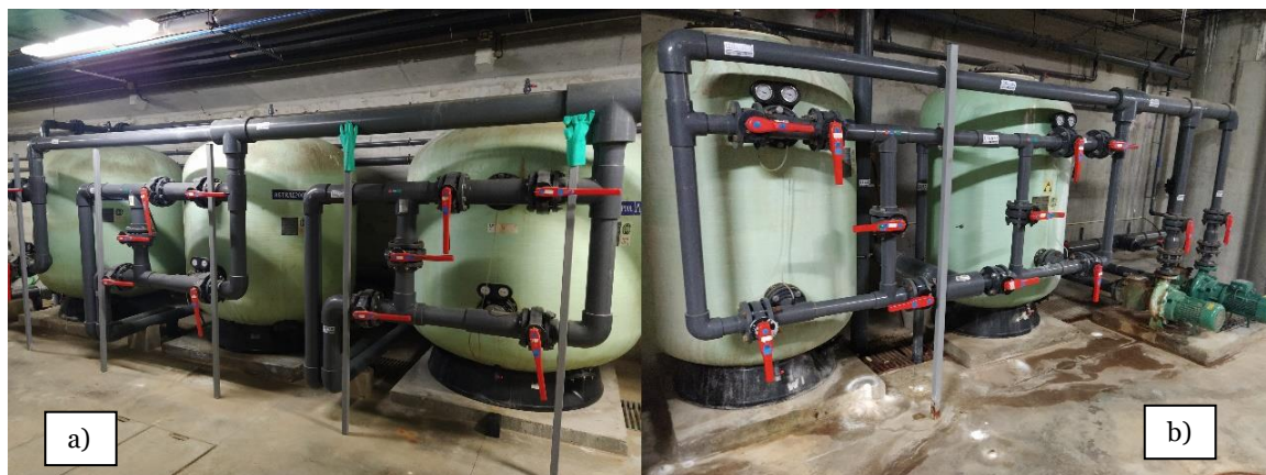
Figura 3.5 - a) Filtros do tanque de competição; b) Filtros do tanque de aprendizagem
