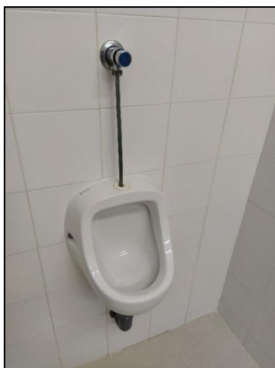
Figura 3.19 - Mictórios existentes nas instalações das piscinas municipais
