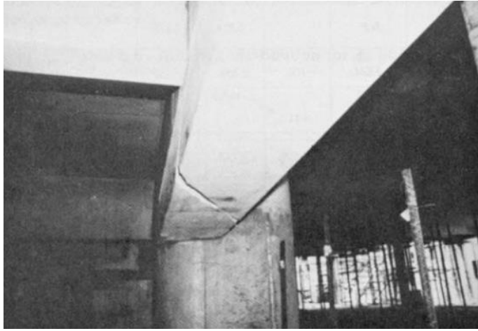
Figura 1.3 - Rotura por torção numa viga de um edifício [20]
