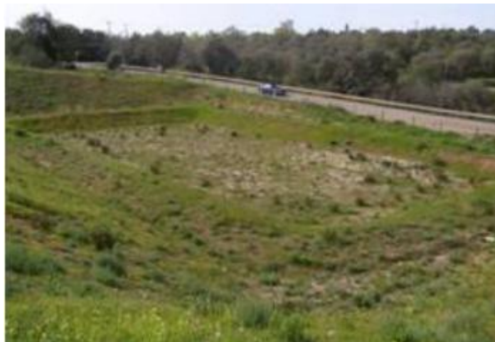
Figura 3.7 - Bacia de infiltração para AEE
