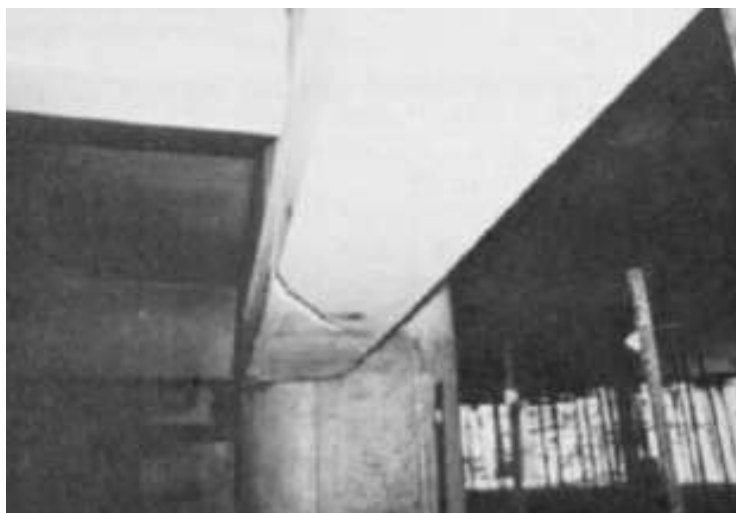
Figura 1.5- Fenda helicoidal numa viga em virtude da falta de armadura específica de torção [17]
