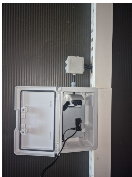
Figura 5.12: Caixa técnica com instalação elétrica e um Raspberry Pi montada na parede, ligada ao sensor inserido no tanque, junto a esta caixa técnica.
