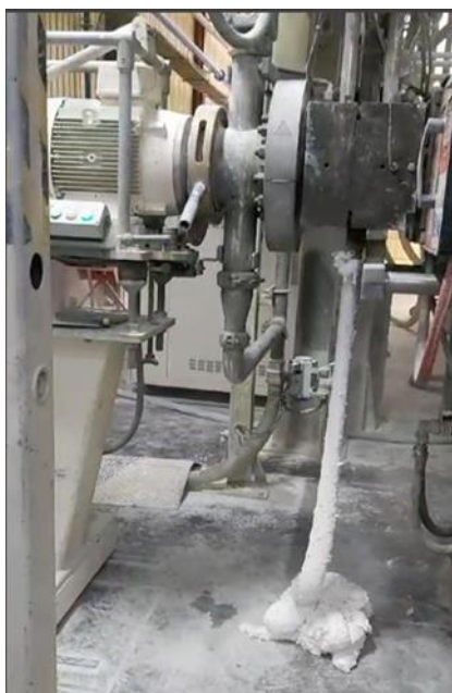
Figura 26: Válvula de purga.
