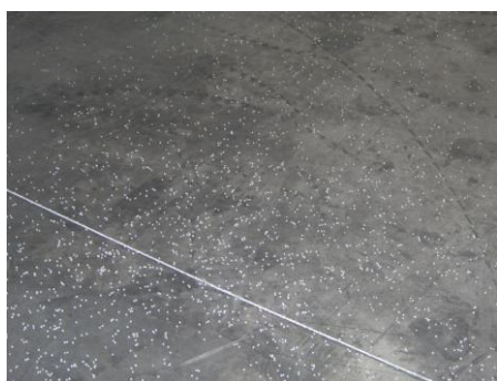
Figura 13 – Risco de escorregamento
