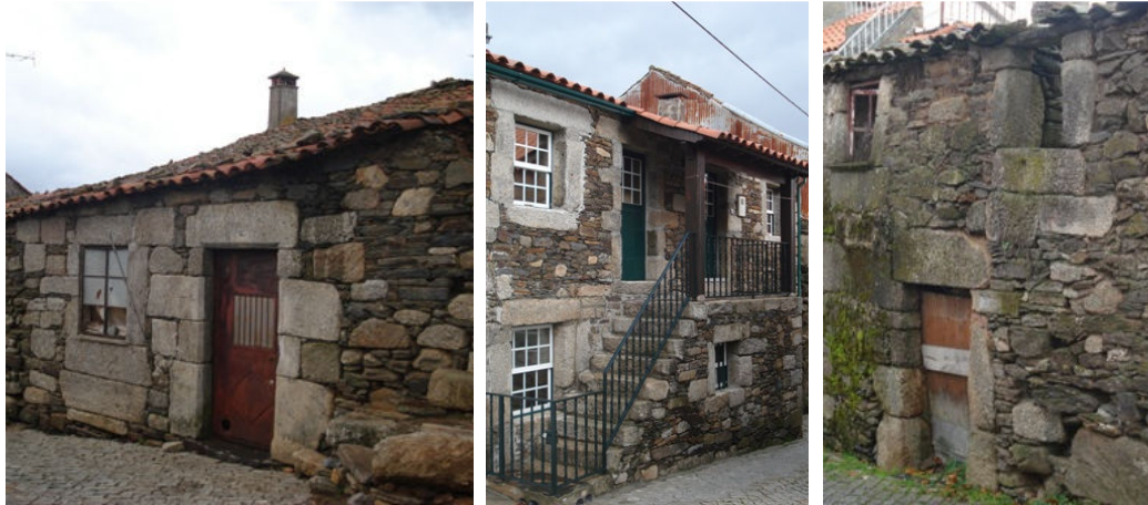
Foto 3 – Habitações tradicionais em xisto, com reforço de vãos em granito, no Sabugal
