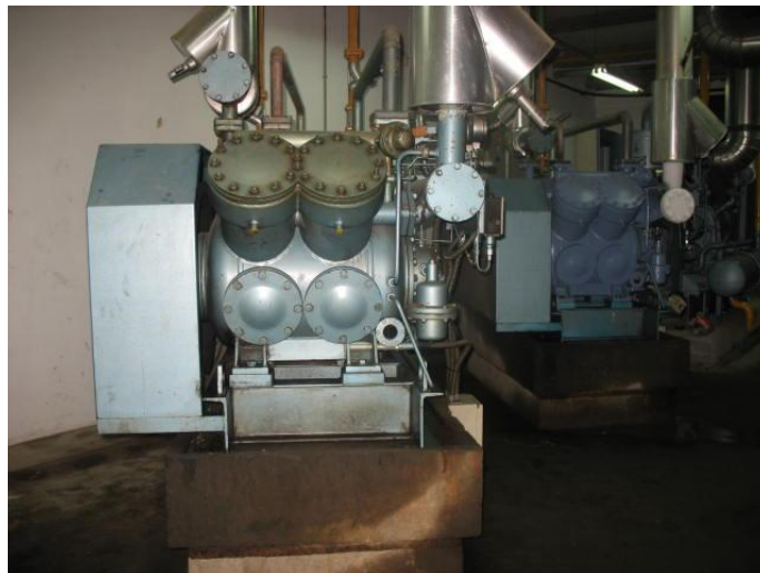
Figura 1.7 - Grupo de compressores alternativos e separadores de \text{NH}_3 da Frulact da Covilhã, Ponte Pedrinha. (Fonte: Autor)
