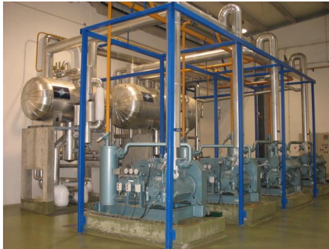
Figura 1.6 - Grupo de compressores alternativos e separadores de \text{NH}_3 da fábrica da Covilhã. (Fonte: Autor)
