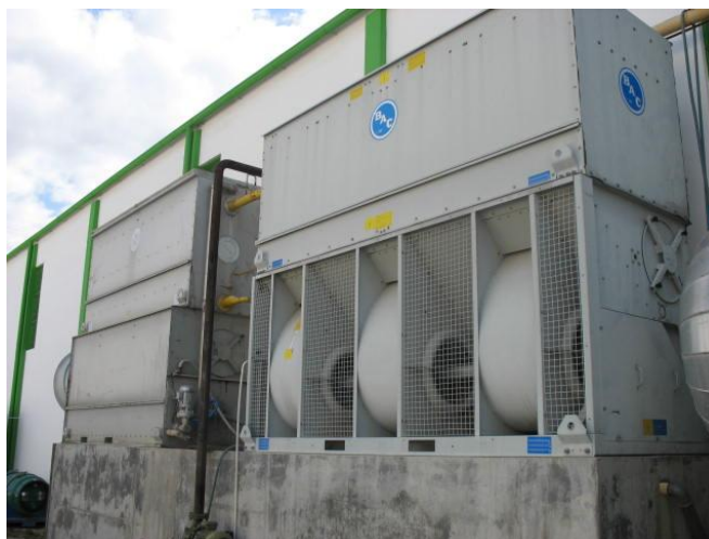
Figura 1.5 - Condensadores evaporativos das unidades de compressão de \text{NH}_3 na Frulact da Covilhã. (Fonte: Autor)
