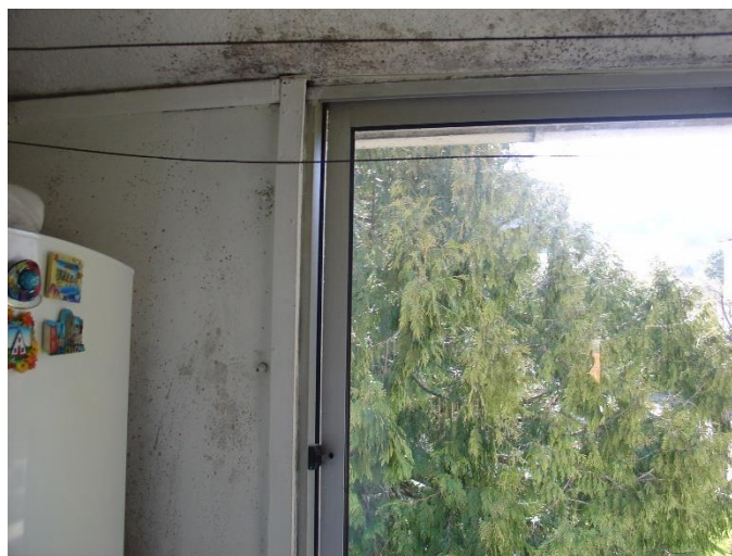
Figura 5.21 - Manchas de bolor e fungos na cozinha.
