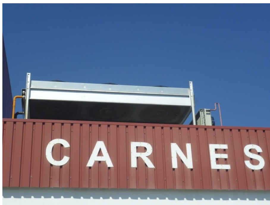
Fig. 12 -Condensadores na cobertura do edifício (Cortesia: Viegas e Lucito, Lda.).
