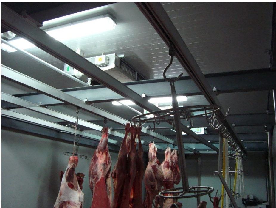
Fig. 14 -Localização dos evaporadores e via aérea, na câmara frigorífica 1 (Cortesia: Viegas e Lucito, Lda.).
