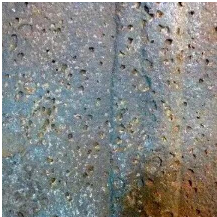
Figura 8: Exemplo de corrosão por pites
