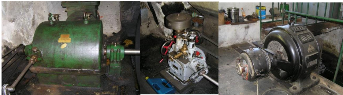
Figura 28 - Turbina do tipo Banki com 40cv de potência e alternador com potencia de 32kVA
