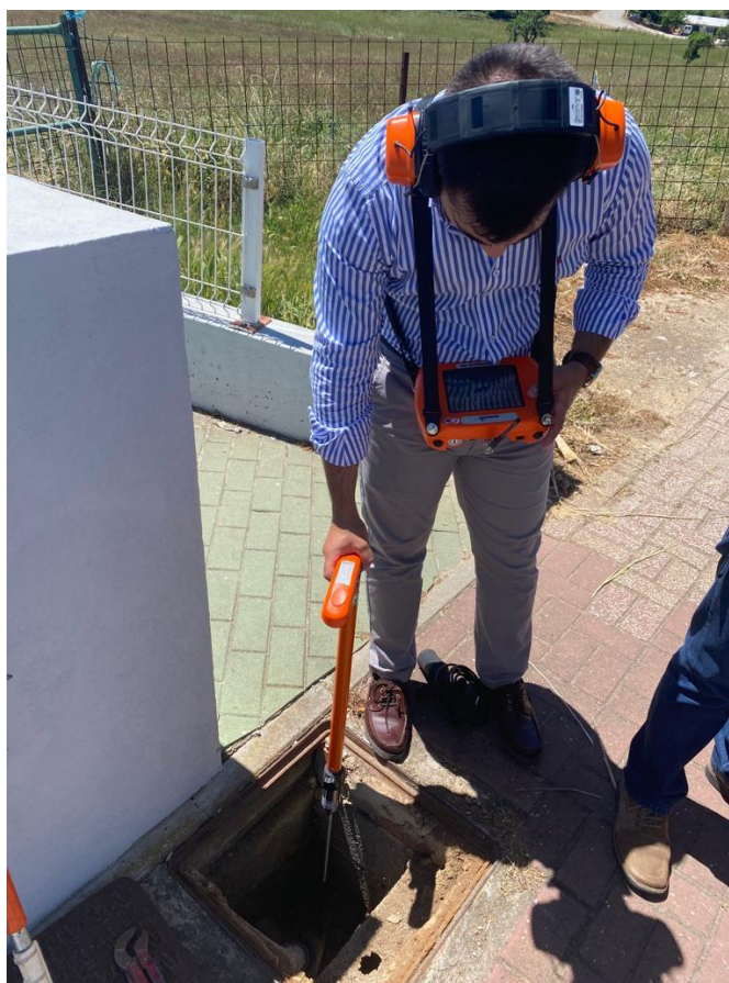
Figura 76 - Operação “Detecção de Fuga” para pré-localização, com a Vara de Escuta TS200 instalada
