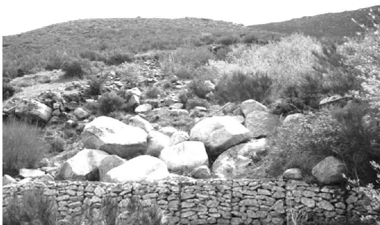
Figura 35 - Queda de blocos EN338.
