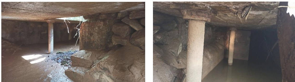
Figura 98 CGE - Cave Técnica, apoios do motor diesel e tapamento em pedra, 2021 (fotografia do autor)
