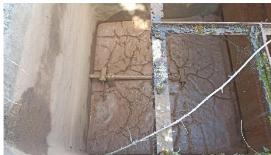
Figura 103 CGE - Tanque da Turbina, 2021 (fotografia do autor)
