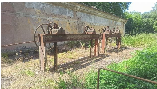
Figura 102 CGE - Comportas para tanques das turbinas, 2021 (fotografia do autor)
