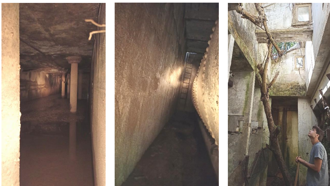
Figura 99 CGE - Cave técnica, 2021 (fotografia do autor)
