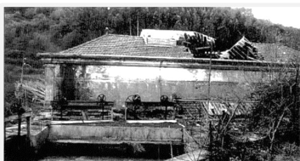
Figura 23 CGE - degradação da Central Geradora de Eletricidade, 1996 (fotografia retirada de uniralcobaca.blogspot.com)
