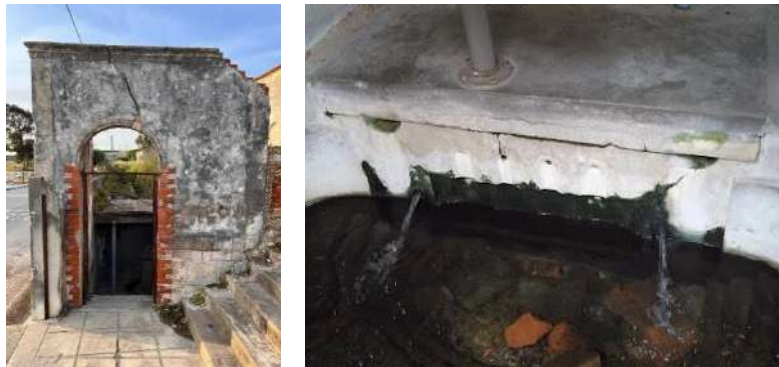
Figura 61 – Bicas de água existentes
