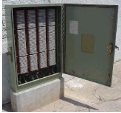
Fig. 4.2: Armário Sub Repartidor na via pública
