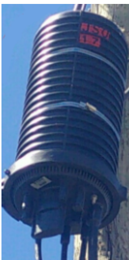
Fig. 4.5: JSO instalada em poste
