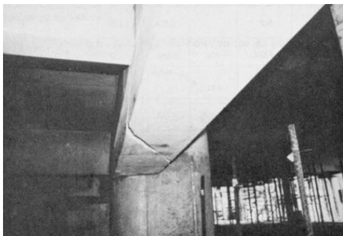
Figura 6 - Fissuração e rotura frágil por efeito de torção [5]
