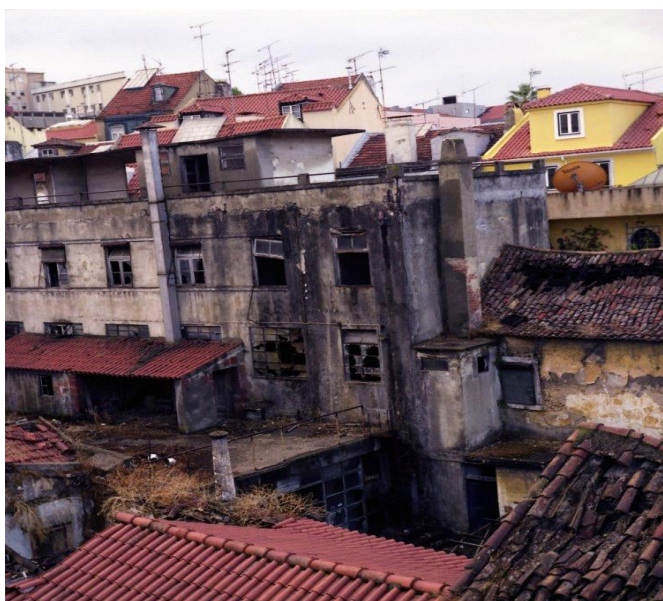
Fig. 59 | Degradação centro histórico urbano, Lisboa. [23]
