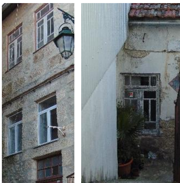
Fig. 142 | Estado das caixilharias e envidraçados (fachada este e fachada sul, respectivamente).
