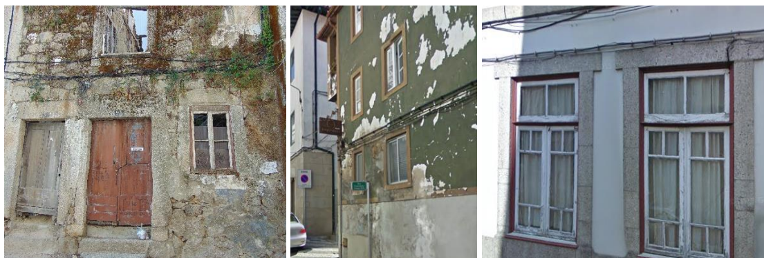
Fig. 113 | Estado de alguns edifícios, Covilhã.
