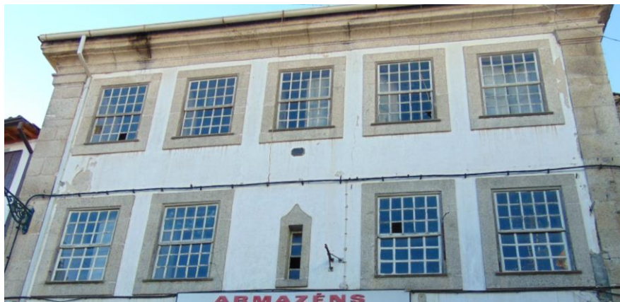
Fig. 141 | Estado das janelas e dos seus componentes.
