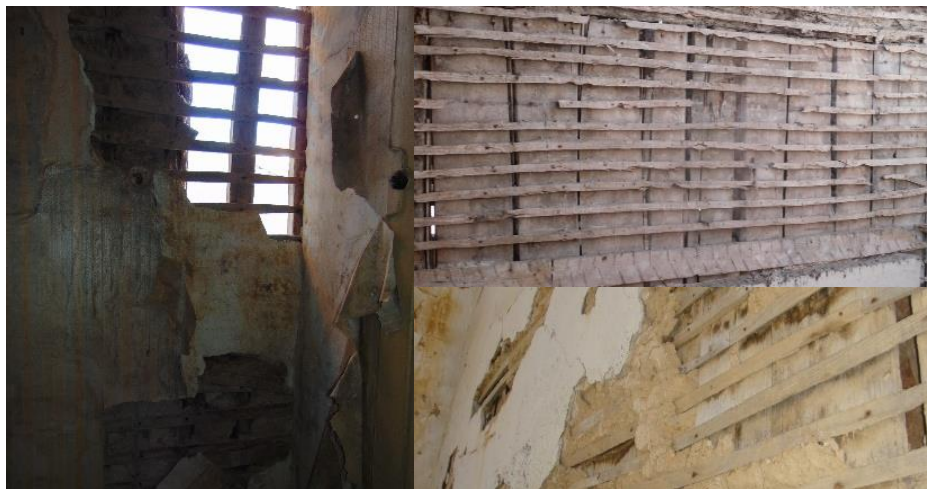
Fig. 138 | Parede em tabique com graves anomalias, Covilhã.
