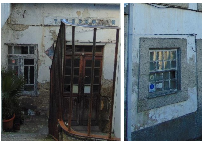
Fig. 143 | Estado do revestimento exterior.
