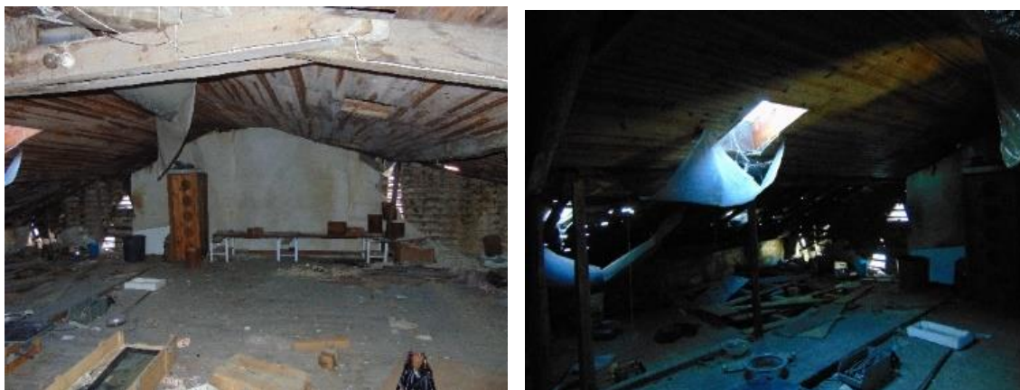
Fig. 139 | Estado de degradação da cobertura.
