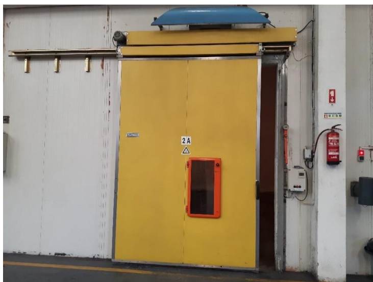
Figura 15 - Câmara de refrigeração (Quinta dos Lamaçais).
