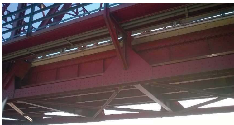
Figura 6.14 - Fotografia do banzo inferior de uma das vigas principais da estrutura.
