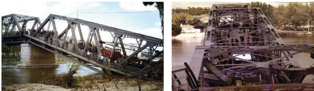
Figura 4.3 - Colapso do tramo metálico em 1979 9 .
