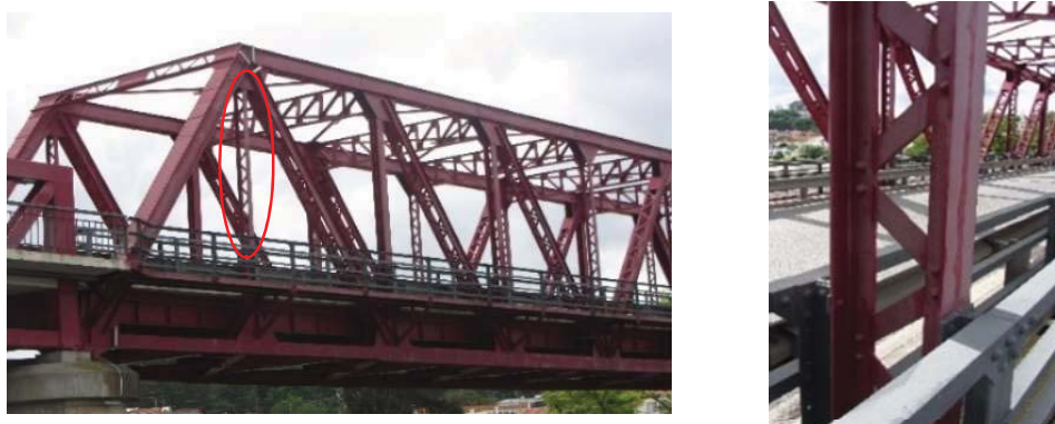
Figura 4.22 - Fotografias do perfil montante 1 da ponte.
