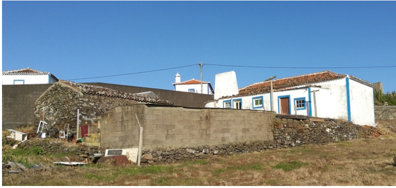
Figura 99 - Casa alongada, fachada do alçado tardoz antes da reabilitação, Santa Bárbara, Norte (Buildingazores, 2016)
