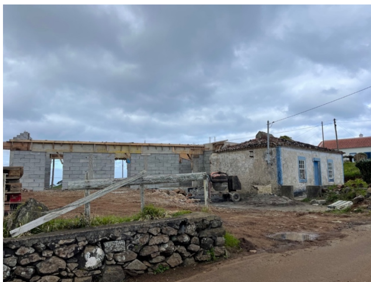
Figura 88 - Obra em andamento de uma reabilitação e ampliação de casa típica, mantendo o volume da casa existente, Santa Bárbara, 2023
