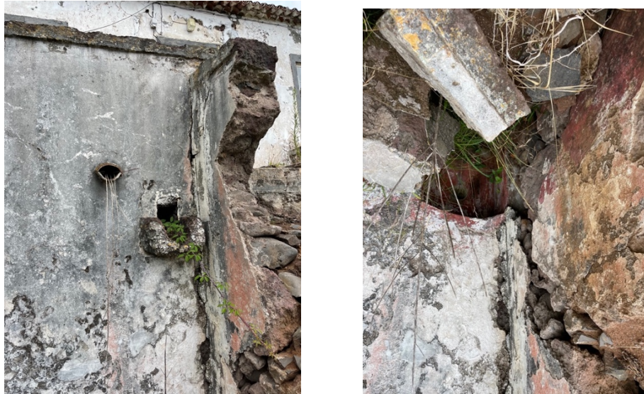
Figura 76 - Caleira proveniente da cisterna de baixo do balcão, onde sai as águas da chuva aproveitadas na casa, Praia Formosa, 2023
